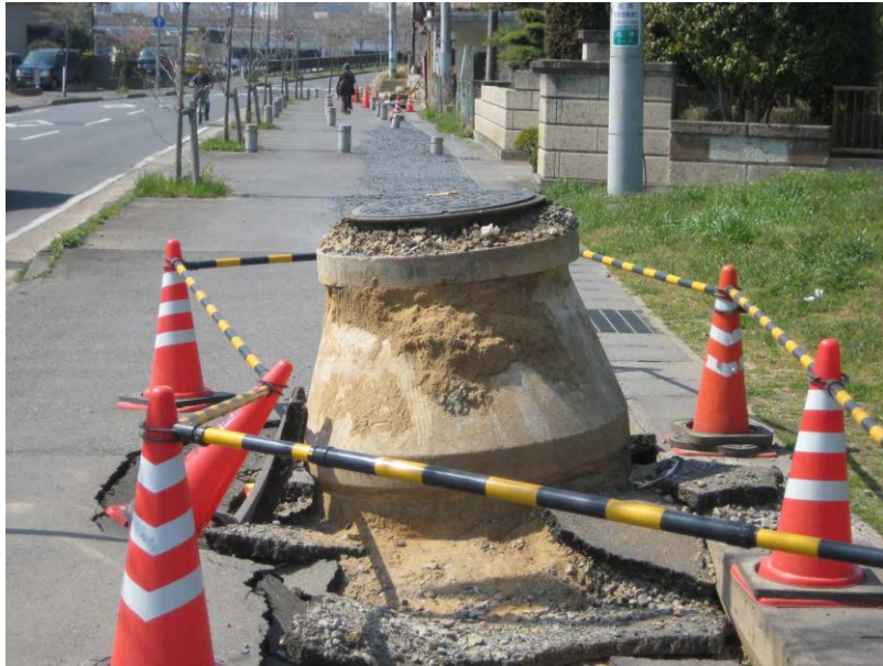
液状化現象で押し上げられたマンホール（茨城県石岡市）
