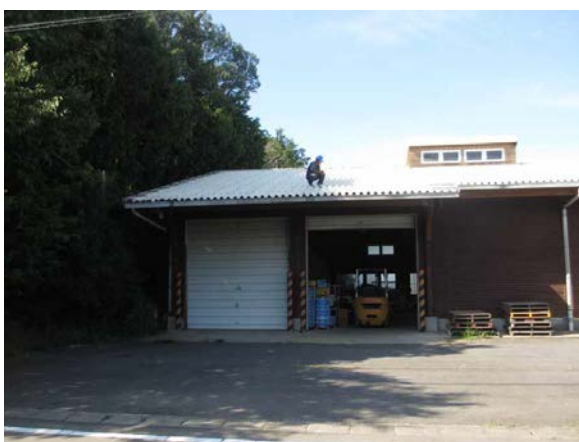
南向きながら日陰が。この部分は設置不可
