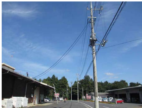
送電にはこの電柱の存在が欠かせません
